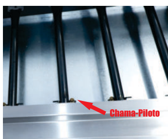
Vista da chama piloto e dos queimadores estalados
